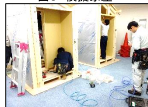
図7 外断熱及び内装
